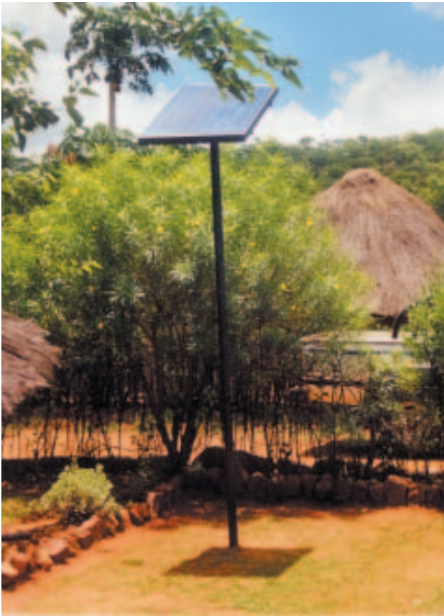
Ce modeste système solaire domestique fournit les services énergétiques de base à un ménage de zone rurale
